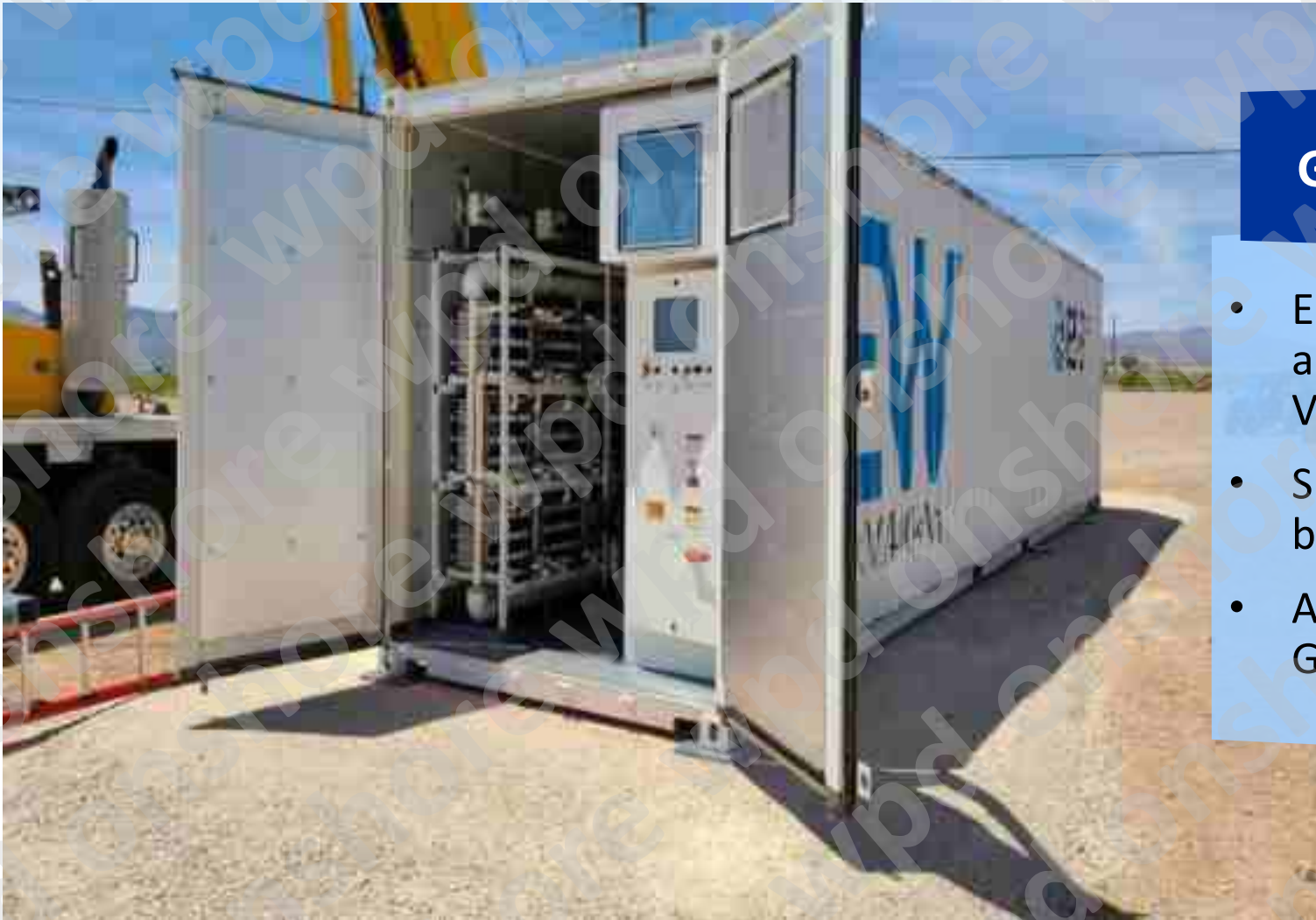
BESS in 20 Fuß Container
